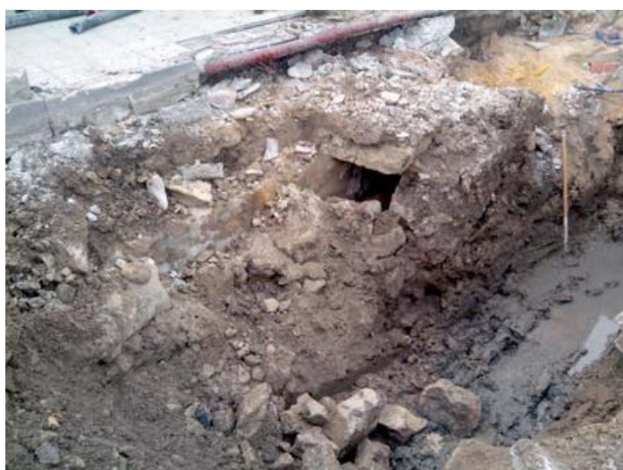
Atarjea de conducción de agua
