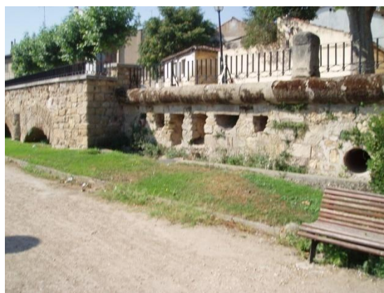
Desagües de la red de alcantarillado
